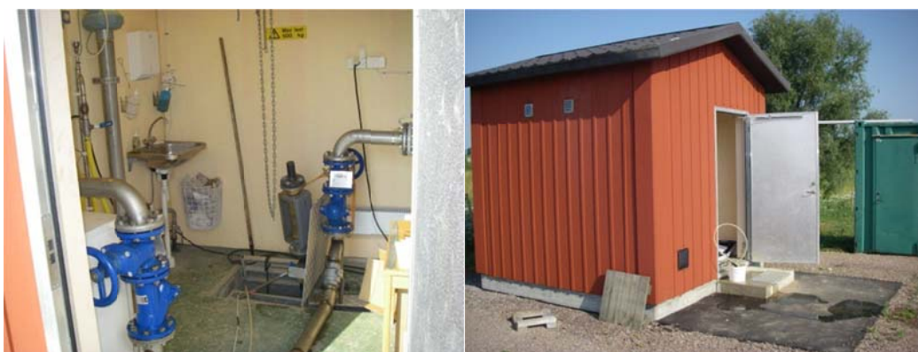
Figur 7. Interiör och exteriör och av den nya pumpstationen.
